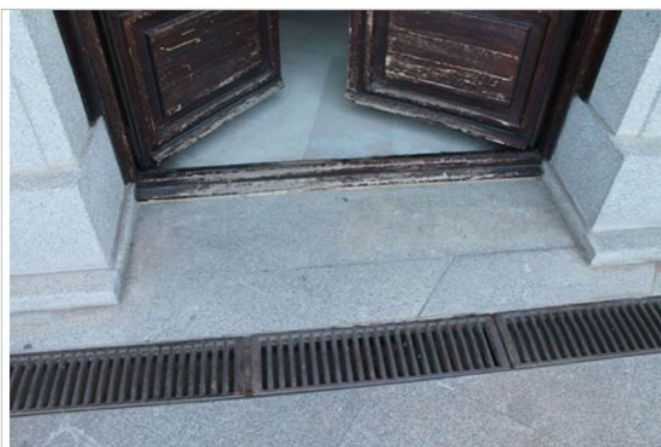
V22. Vista de marco inferior de carpintería de acceso a la terraza de Salón de Falla
